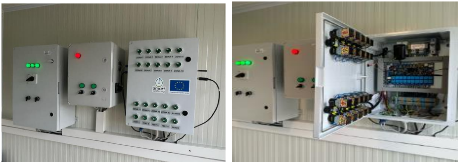
Slika 3. Kućište FERT kontrolera instaliranog na oglednom poligonu PPF-a, Butmir
