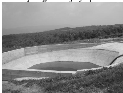
Slika 150. Bazen za prikupljanje vode
